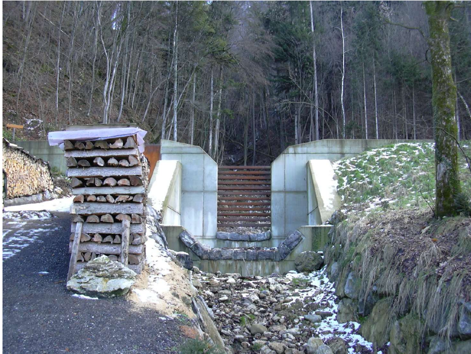
Abb. 3.7: Geschiebeablagungsbecken mit Balkensperre am oberen Schwemmkegel des Pelzreutebaches (Höfle, 25.12.2004).
